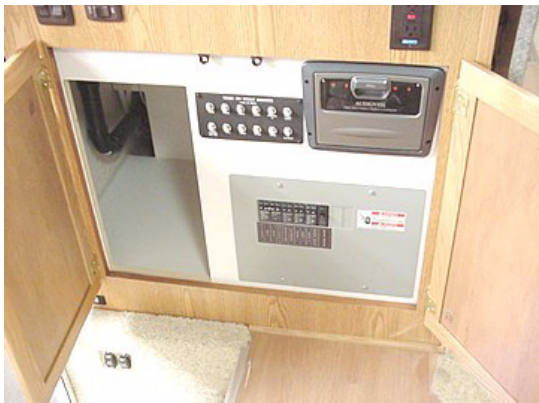
110-Volt Load Center
