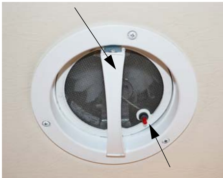
Fan Power Switch
